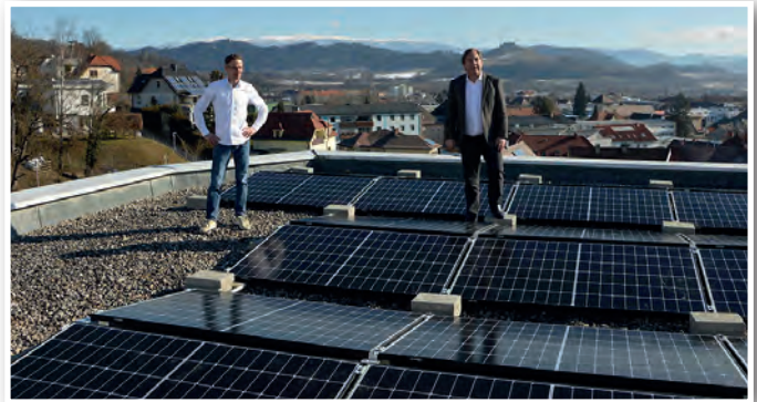
Markus Höck (links) und Michael Steiner präsentieren stolz das erweiterte PV-Kraftwerk.
