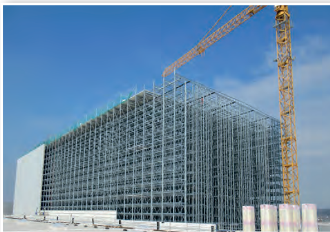
Ein Hochregallager – made by ASSMONT
